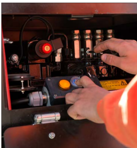
Kontrollpanel for støttebein
